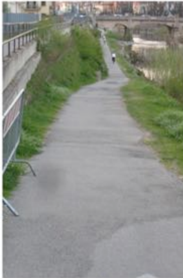
Fig. 85. Rampa 05_Vittoria_Dx - Stato attuale rampa Sud oggetto di intervento abbattimento barriera architettonica.
