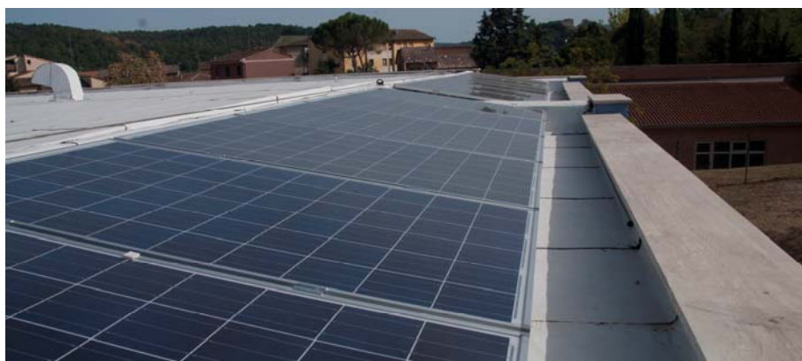
Impianto fotovoltaico realizzato nell'anno 2011 presso asilo nido gemello nel Comune di Monteriggioni (SI)
