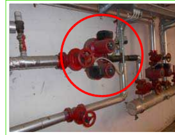
Rif.: P4 POMPA DI CIRCOLAZIONE Tipo: Gemellare Costruttore: GRUNDFOS Modello: UMC 50-60 Portata: 18,0 m³/h Prevalenza: 13,0 mt.c.a.
