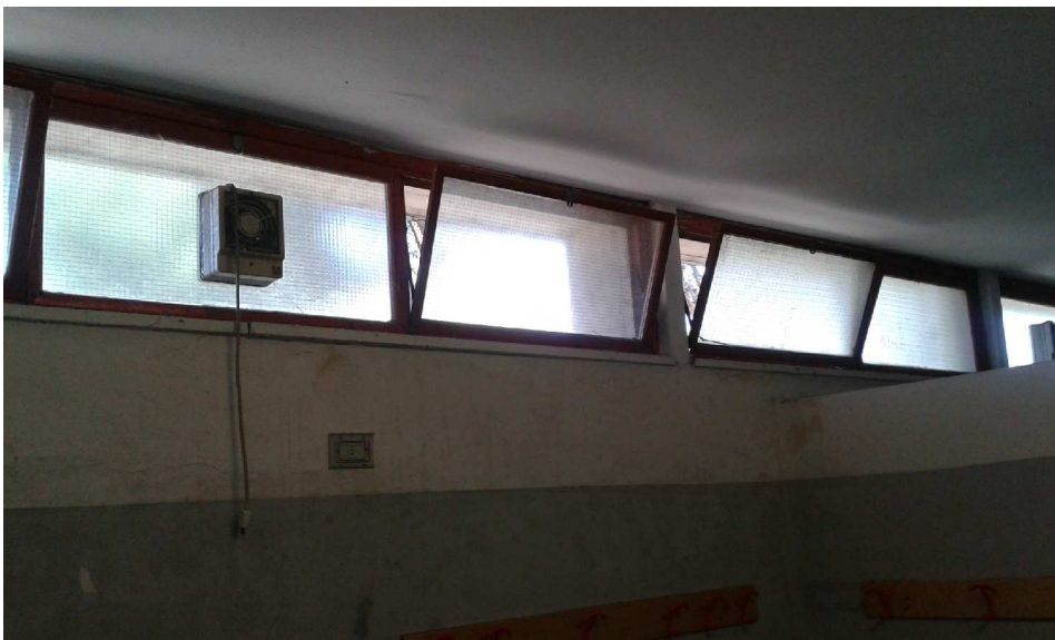
Foto 12 : particolare interno palestra degli infissi da sostituire
