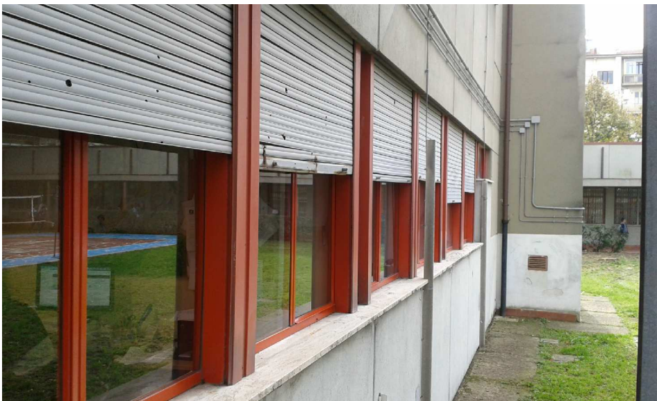
Foto 6 : particolare esterno scuola degli infissi da sostiruire
