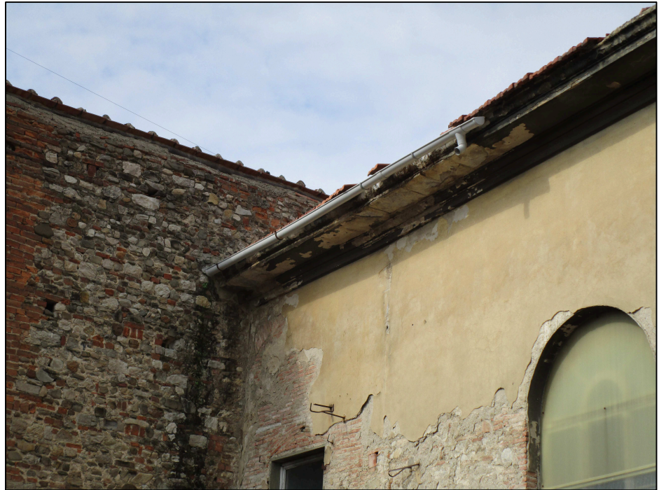
Foto 8 : particolare del tetto da risanare
