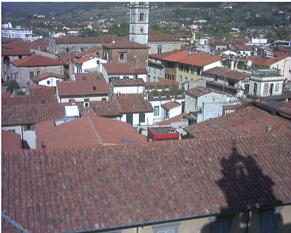
Veduta dei tetti con le torri evaporative
