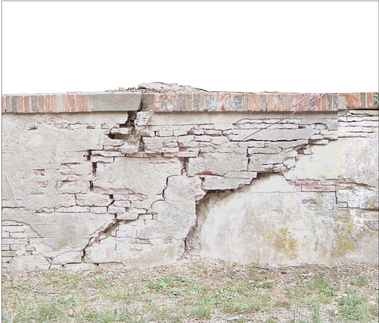
Complesso della darsena, condizioni di degradazione di una spalletta, particolare
