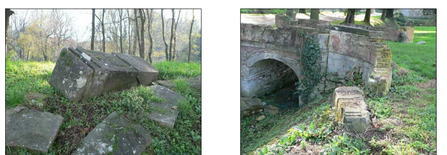
Colonnini in pietra arenaria fuori sede.
