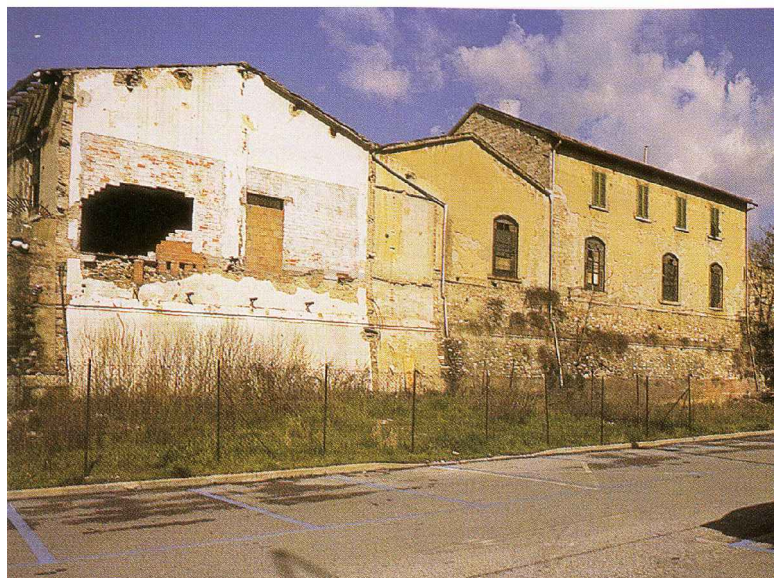
FOTO DEGLI EDIFICI COSTRUITI SOPRA IL BASTIONE DELLE FORCHE PRIMA DELL'INTERVENTO DI DEMOLIZIONE 1990-1997
