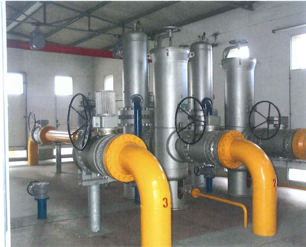
Foto 3. Apparecchiature di filtraggio, preriscaldamento e decompressione
