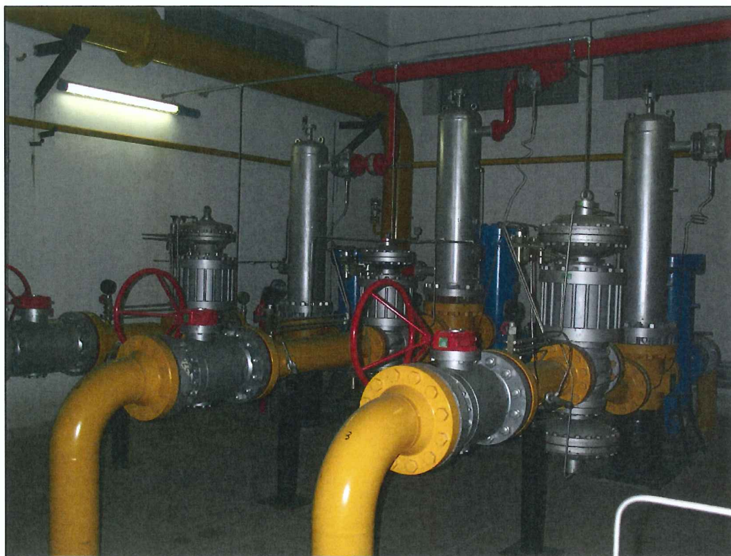
Foto 7. Cabina Re.Mi. – Apparecchiature di filtraggio, preriscaldamento e riduzione.
