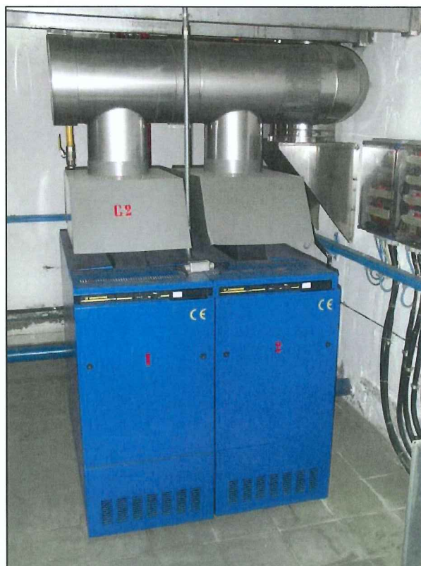
Foto 8. Cabina Re.Mi. – Centrale termica.
