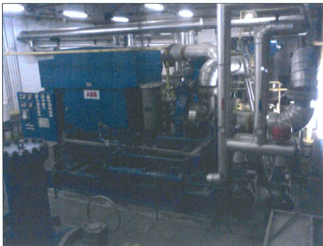
Foto 11. Impianto di turboespansione – Apparecchiature.
