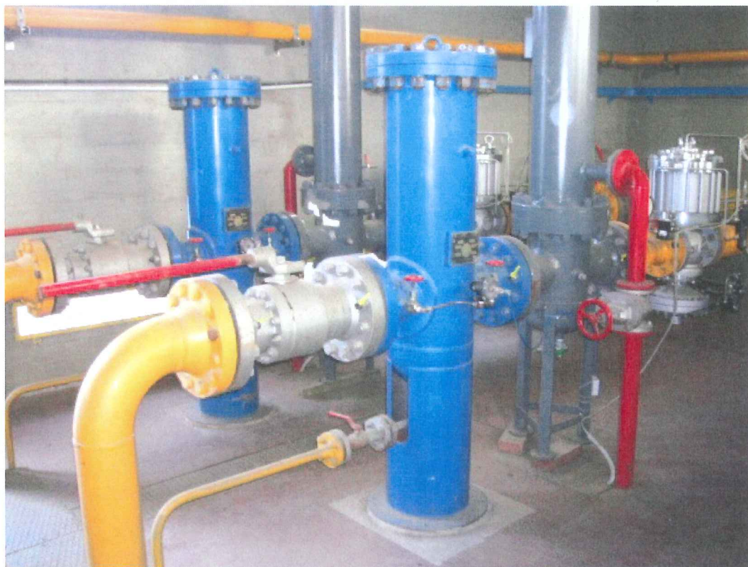
Foto 3. Panoramica linea di filtraggio, preriscaldamento e riduzione.
