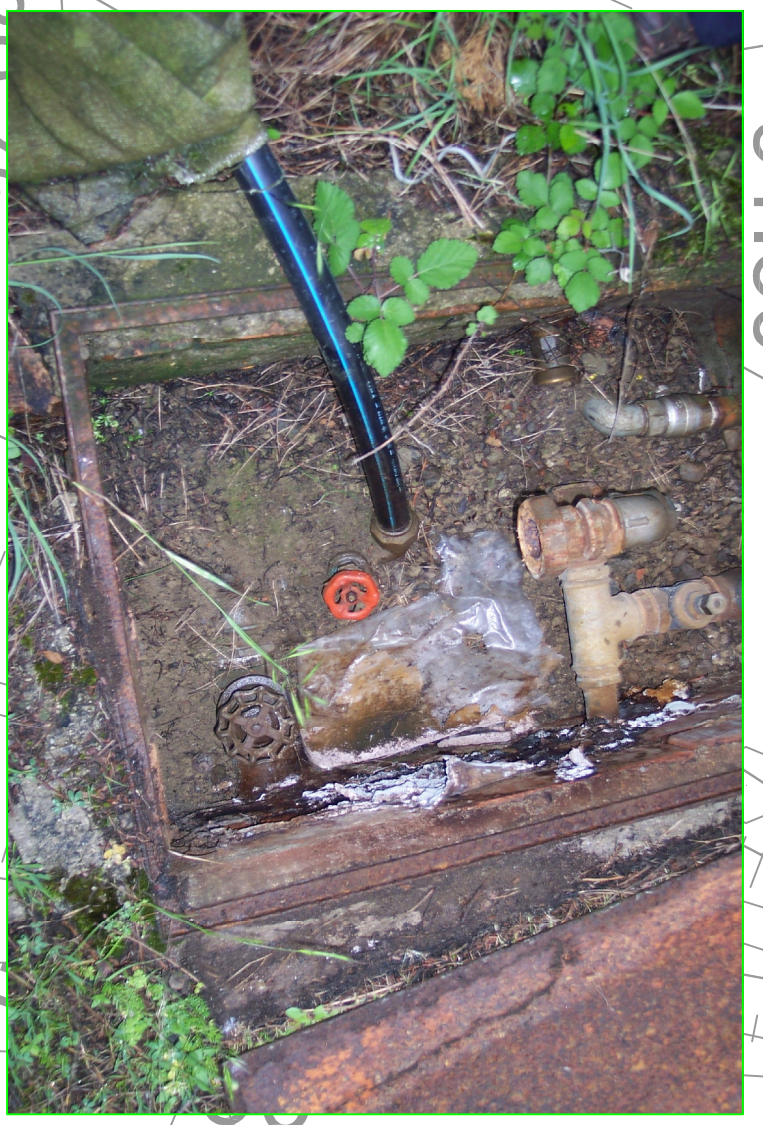
Pozzetto esistente con intercettazioni
