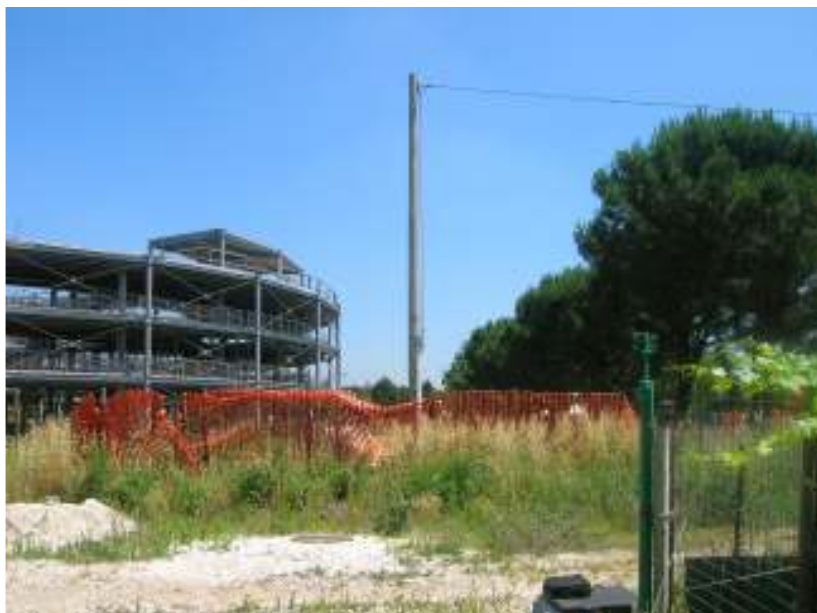
Fig.5 Veduta di palo con cavo elettrico aereo- distanza da braccio della gru min.7mt
